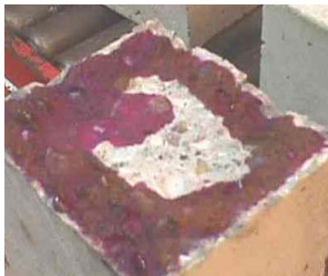
Fig.2.- Color característico del hormigón no carbonatado en el ensayo con fenolftaleína.
